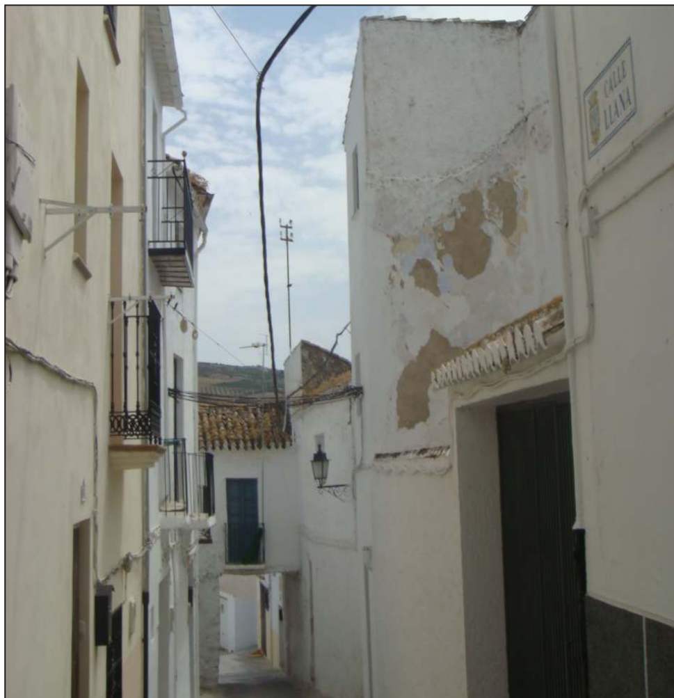
La magnitud de esta incidencia merece un tratamiento singular de eliminación del trazado sobre el eje viario, en este caso, mediante su fijación a una de las fachadas.
