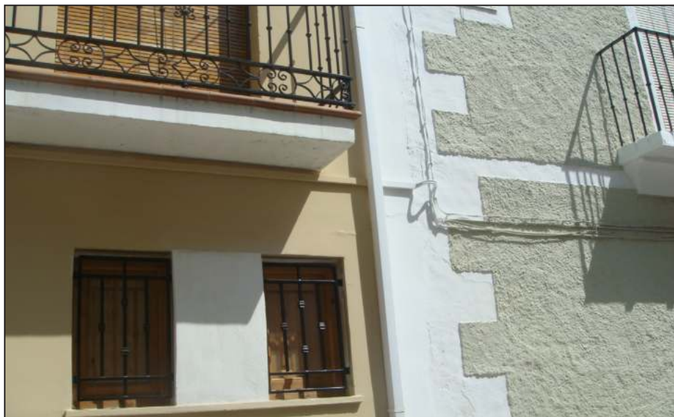
Ejemplo gráfico de dos sistemas de impostaje distinto en fachadas contiguas. La vivienda de la izquierda utiliza regletas ubicadas bajo un saliente, encaladas en el mismo color de la fachada, mientras que la de la derecha sólo utilizada el encalado de los cables, incluso con coloraciones distintas.
