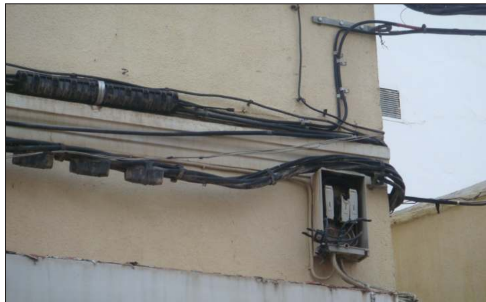
Como primera alternativa, sería recomendable que se corrigieran los defectos derivados del deficiente mantenimiento de estos elementos.
