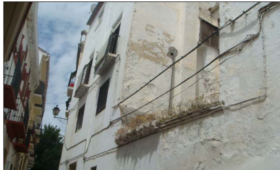
En la imagen se muestra una fachada con cuatro niveles distintos de altura del cableado, resultando patente la mayor afección provocada por el recorrido que supera la cota de la cubierta.
